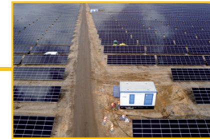
Modulfeld mit Wechselrichterstation
